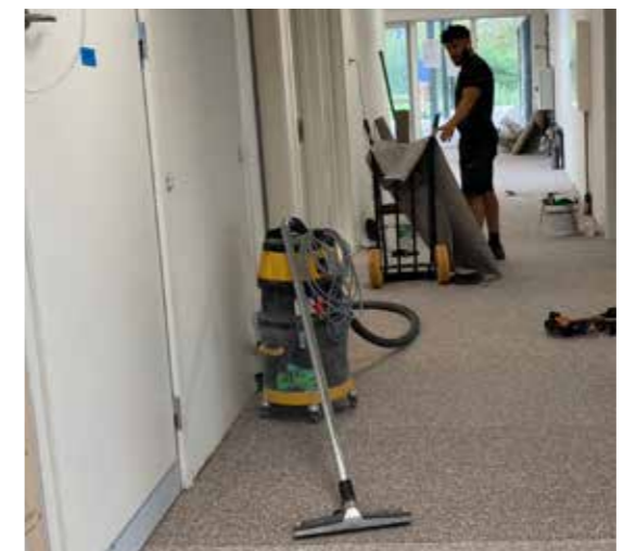
Problemer med revner i gulvet, der skal rettes op, forsinker åbningen af det nye børnehus.
